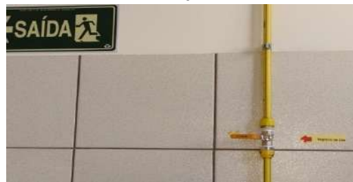
Figura 39. Sinalização Gás. Lab. de Panificação
