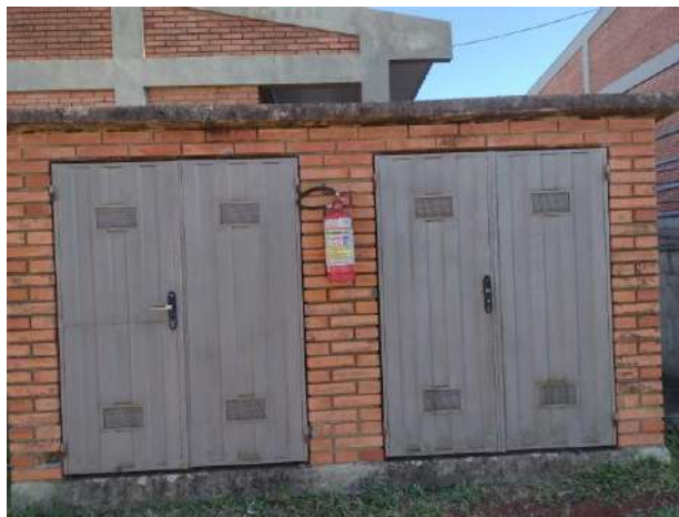
Figura 46. Sinalização de Alerta/Proibição Área Externa (Casa do Gás)
