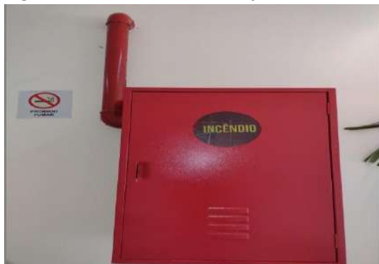
Figura 34. Prédio – D (Sinalização Hidrante)
