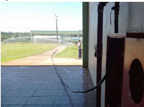
Figura 1. Teste de hidrante
