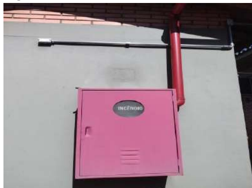
Figura 35. Área Externa - Hidrante
