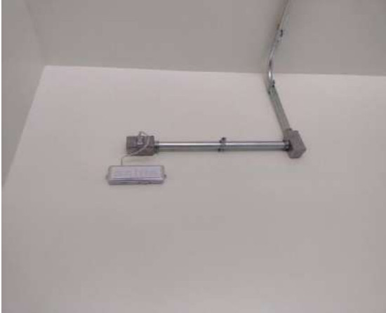
Figura 22. Prédio I – Sala Técnica Laboratório
