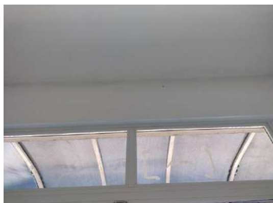
Figura 29. Prédio – D Sinalização Saída
