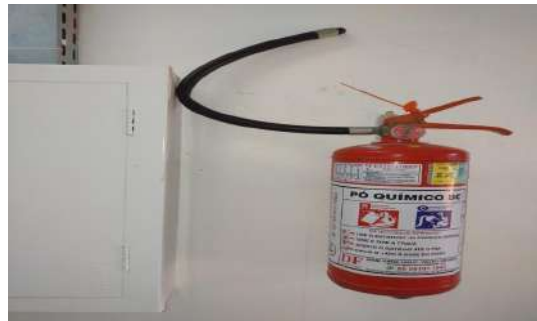
Figura 6. Extintor (sem placa de sinalização e mangueira solta)
