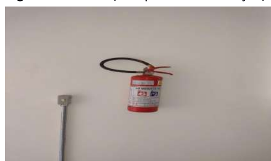
Figura 4. Extintor (sem placa de sinalização)
