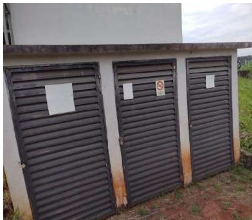
Figura 47. Sinalização Alerta/Proibição Área Externa (Prédio - I)
