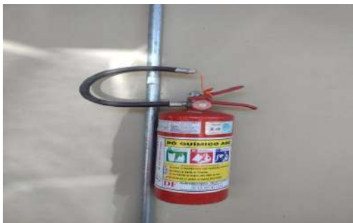
Figura 5. Fundos – Extintor (sem placa de sinalização e mangueira solta)
