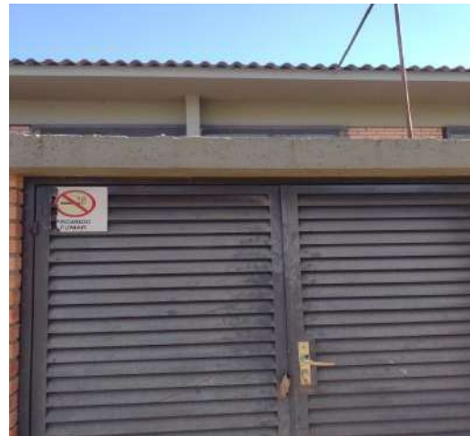
Figura 45. Sinalização Alerta/Proibição Área Externa
