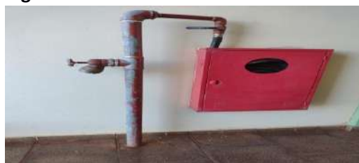
Figura 17. Eletromecânica Hall de Entrada
